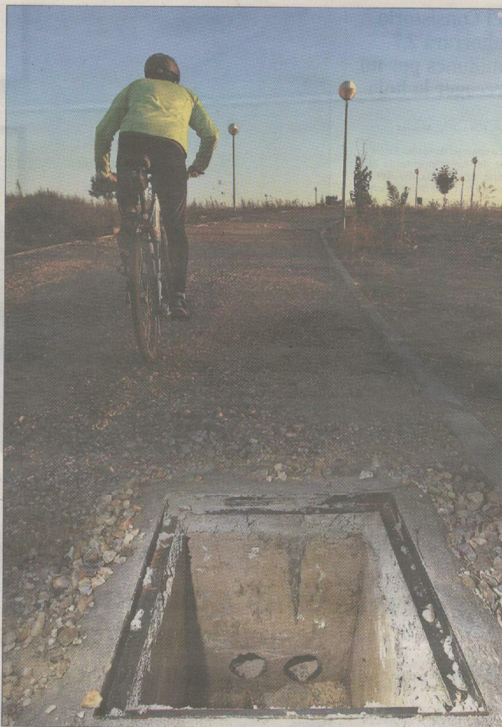
Arqueta de un parque de Villaverde Bajo tras el supuesto robo de cables. / CARLOS ROSILLO
