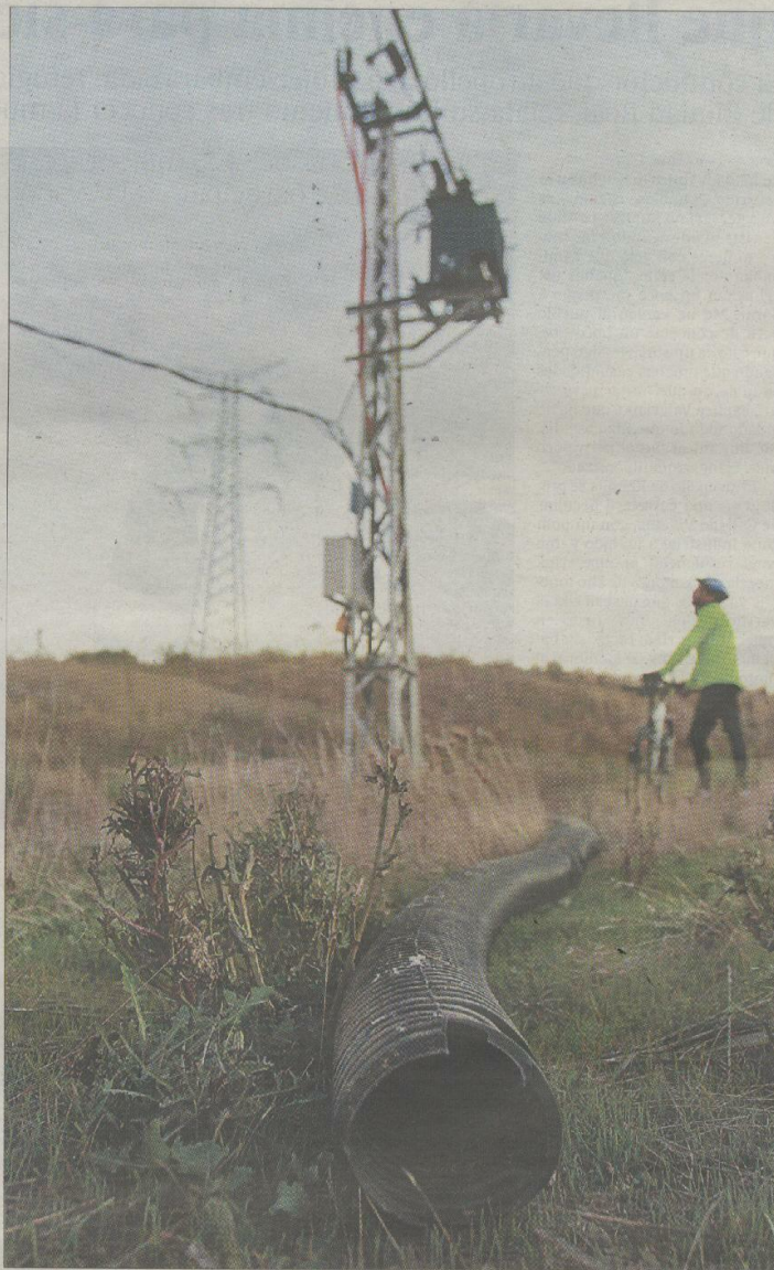
Un trozo de cubierta de plástico, de cuyo interior se ha sustraído el cable, en Villaverde Bajo. / CARLOS ROSILLO
