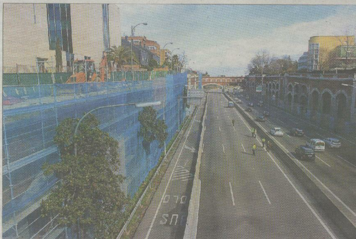
Imagen de la autovía A-2 cortada y de la obra de la que se han despedido restos de material. / ÁLVARO GARCÍA
