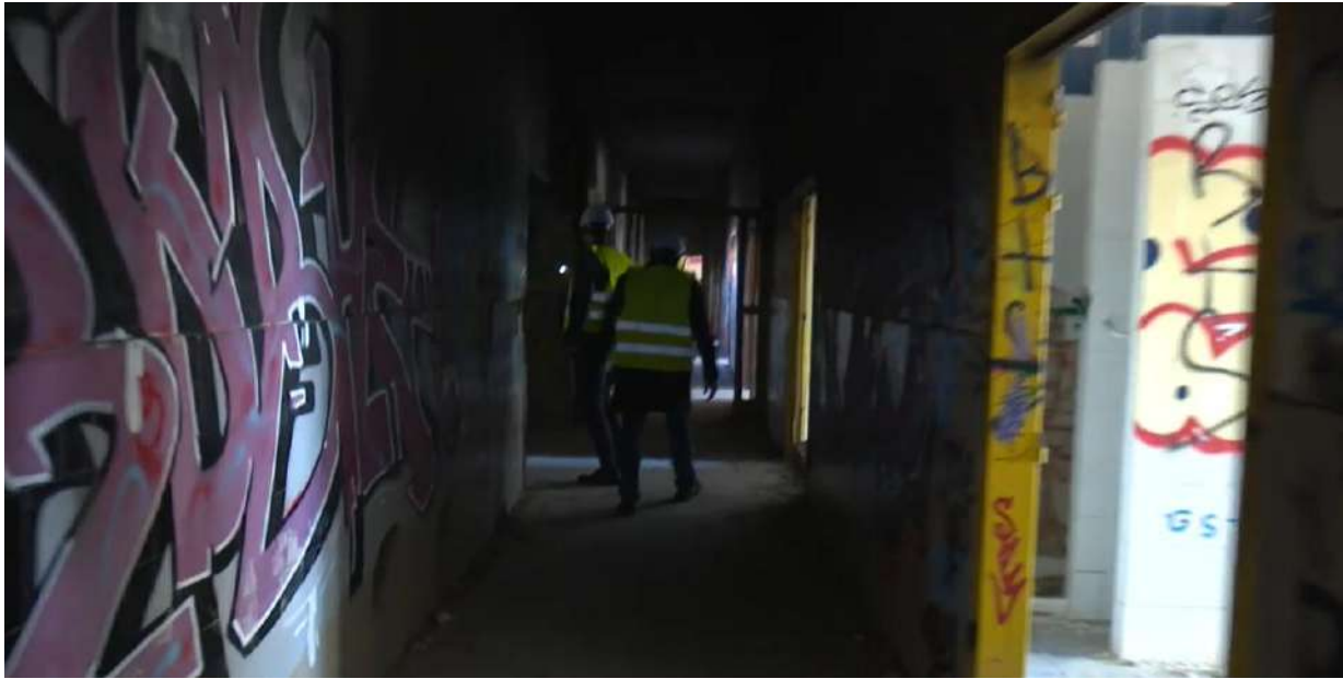
Fig. 21. Interior de las edificaciones militares; se observa el estado de abandono y los signos de vandalismo
