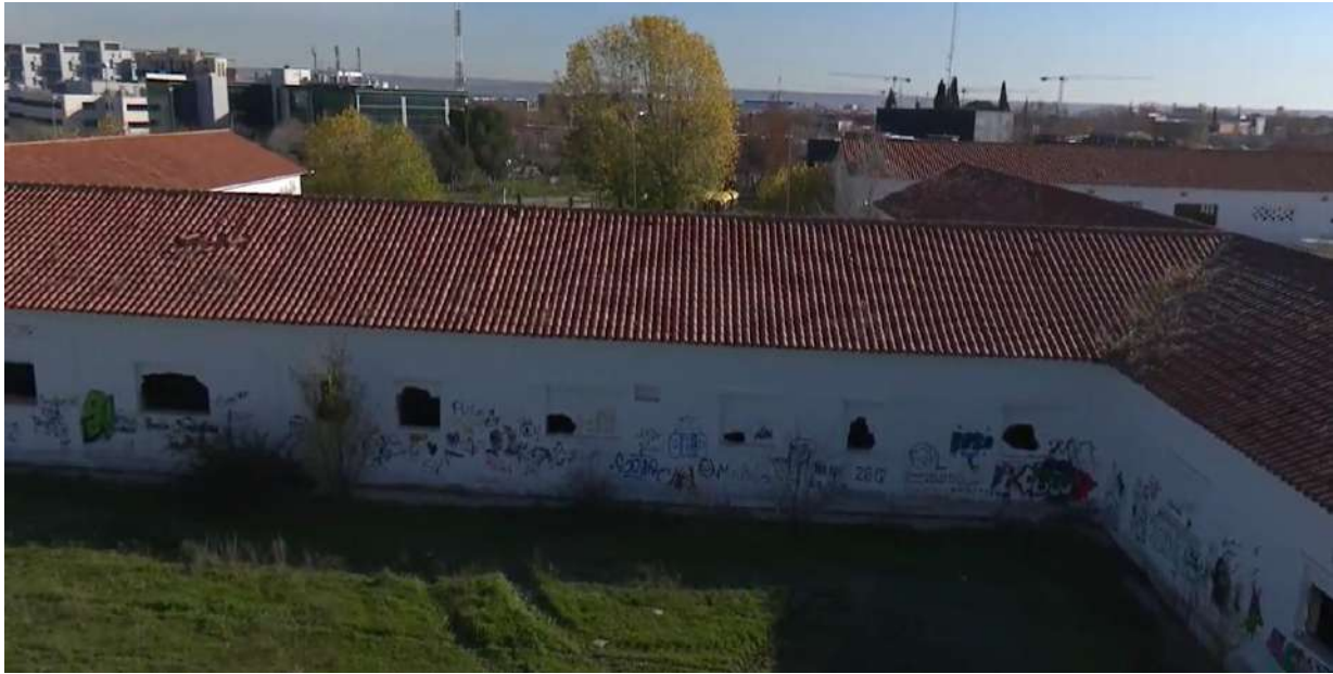
Fig. 15 . Edificio H, ya en estado de abandono
