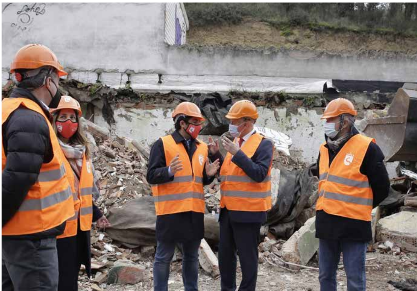
▲ El vicealcalde delegado de Obras y Servicios, Miguel Ángel Martín Perdiguero, y el alcalde, Narciso Romero, al pie de las obras.
