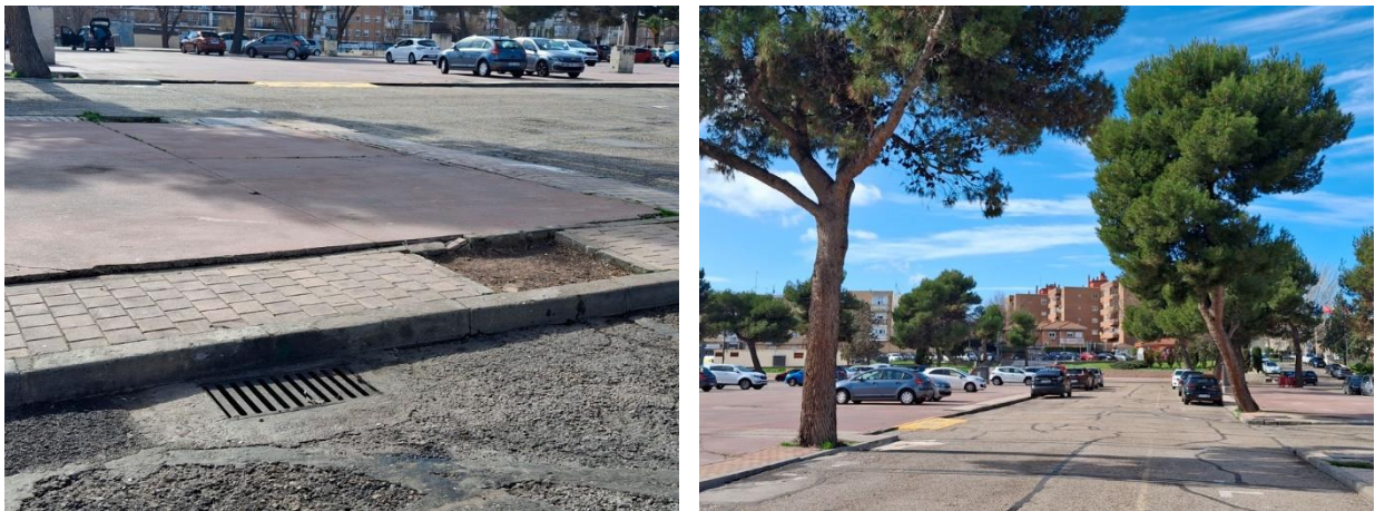
Fig. 4. Estado del pavimento y los alcorques en el Recinto Ferial.
